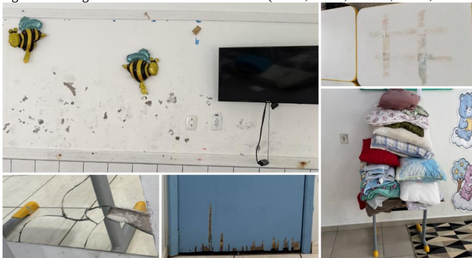
Figura 12 - Fragilidades estruturais evidenciadas (CV62, CV94, CV333, CV50, CV321)
